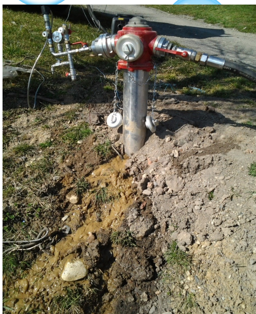
Primer ene od napak na spojih med kontrolo tesnosti cevovoda.
