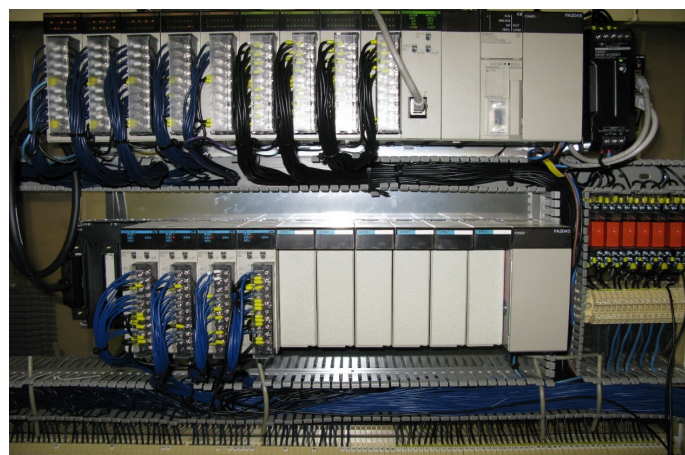
Krmilnik nadzora in upravljanja delovanja črpališča
