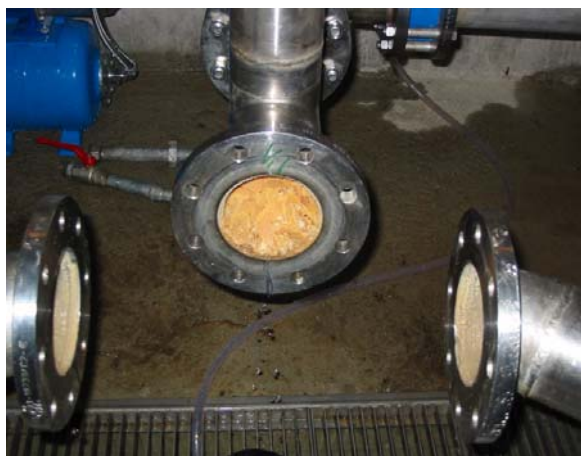
Zamašena cev v vodohranu Urban pri Joštu – vodni kamen
