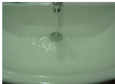
Slika 2: stanje vode po daljšem izpiranju interne instalacije
